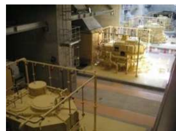
4台のポンプで、25mプールの水を約1秒で排水（最200m³/s）
