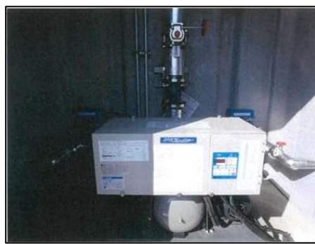
改修対象給水ポンプ
