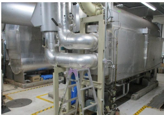
吸収冷温水機
