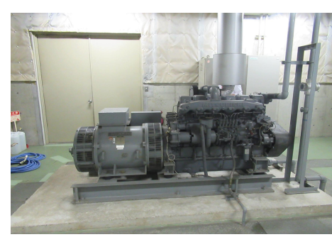
⑥ 撤去予定の発電装置
