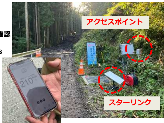
スターリンク+アクセスポイント設置
