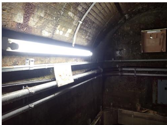
照明設備（監査廊）
