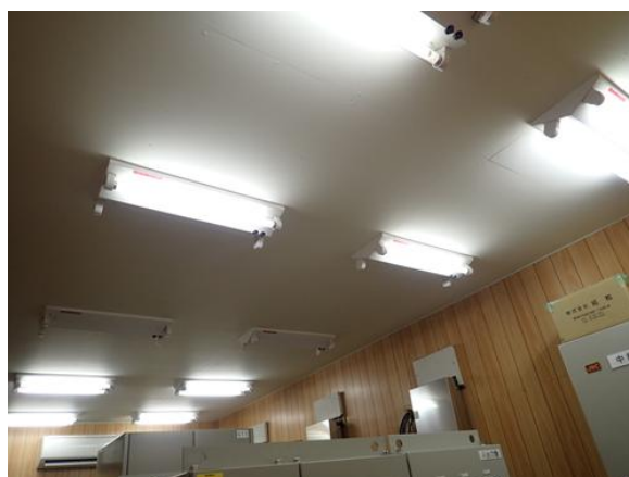
照明設備（堤体内伝送機器室）
