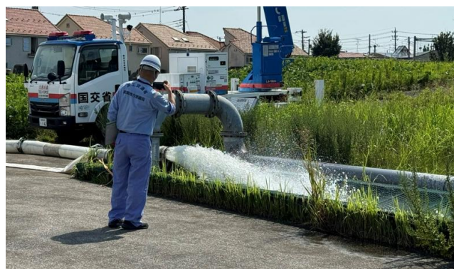
排水ポンプの排水状況（イメージ）
