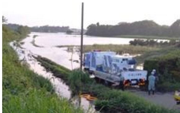
令和5年台風第13号における排水ポンプ車作業状況 （千葉県茂原市御蔵芝付近）
