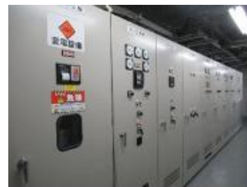
受変電キュービクル(3階電気室)
