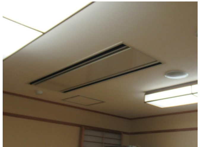
ファンコイルユニット
