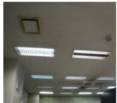
天井照明器具
