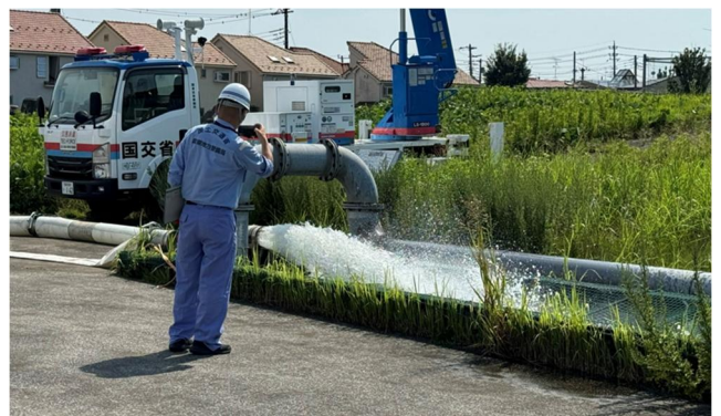
排水ポンプの排水状況（イメージ）
