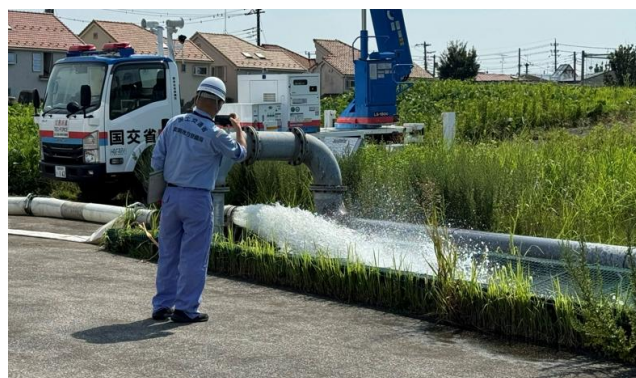
排水ポンプの排水状況（イメージ）
