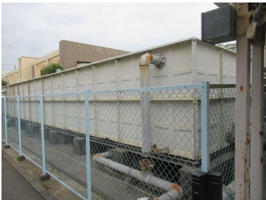
① 受水タンク
