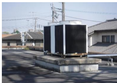
古河出張所室外機
