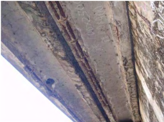
・主桁の剥離・鉄筋露出 <主桁補修>
