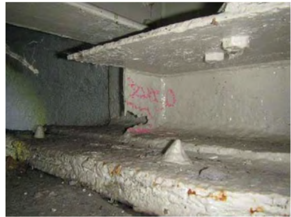
・主桁の腐食 <縦桁補修>
