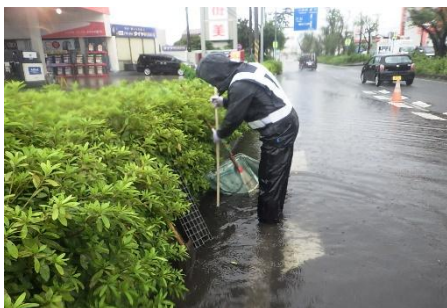
冠水処理 (国道1号)
