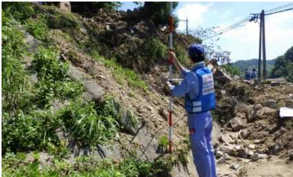
被災状況調査
