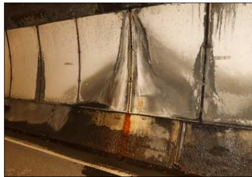
老朽化状況(既設トンネル)
