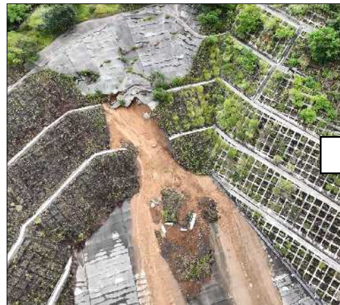
令和6年台風10号による被災状況
