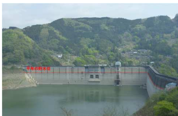
令和8年4月17日時点の貯水位の状況
