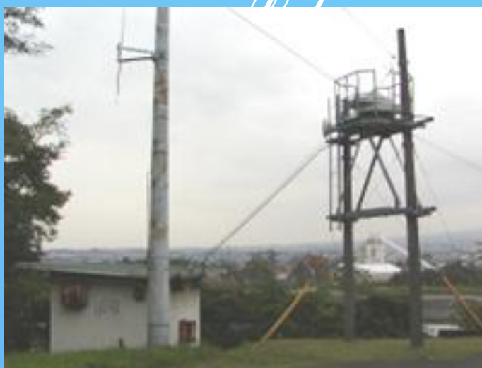
放流警報設備(局舎外観)
