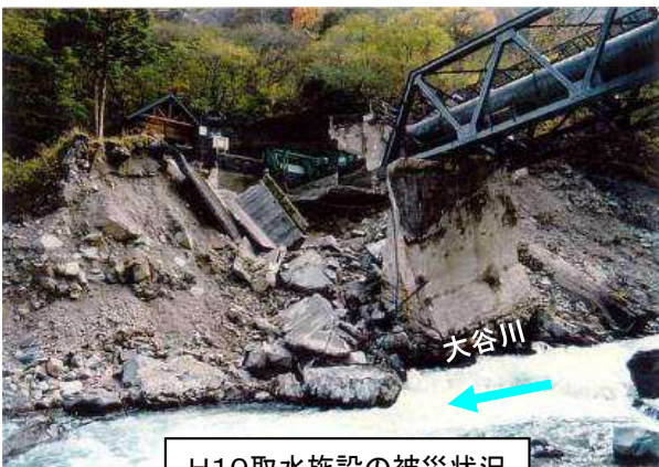
H10取水施設の被災状況
