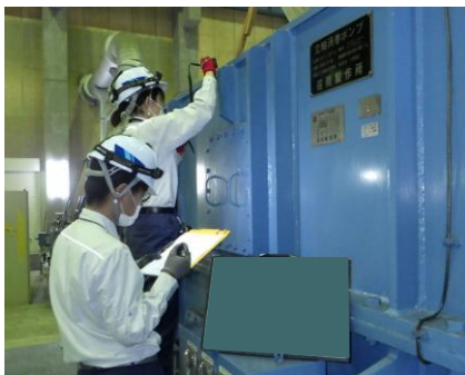
主ポンプ設備定期点検状況
