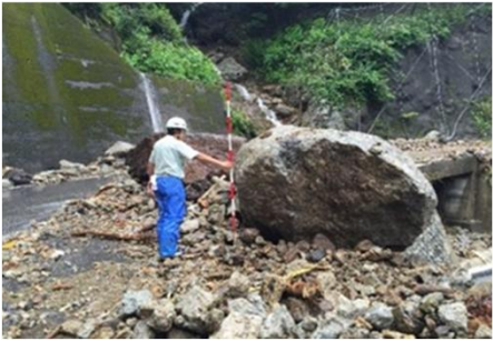
落石状況(平成27年9月)
