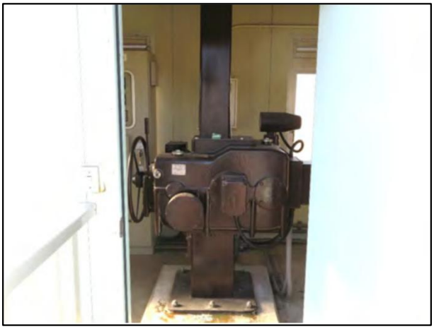
既設開閉装置
