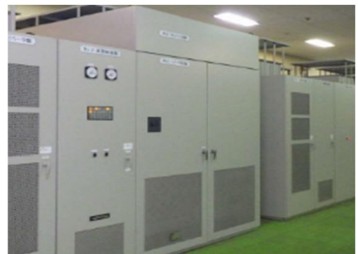
部品入手が困難となっている速度制御装置を合理化(簡素化)
