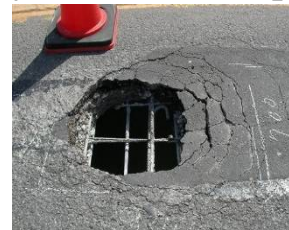
【道路が損傷した例】
