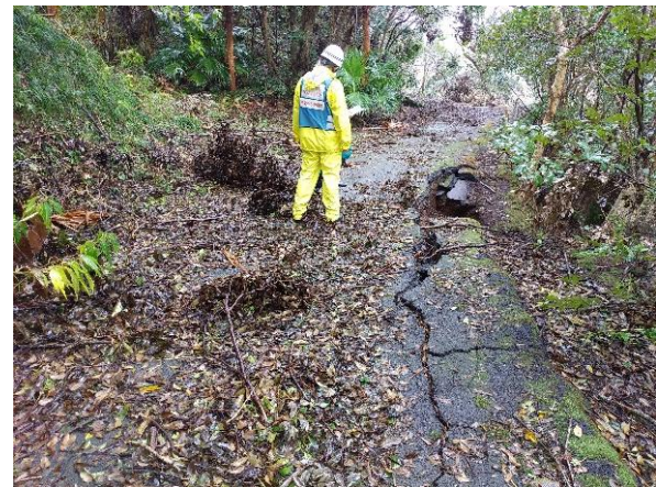
被災状況調査
