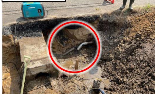
断水後の状況
