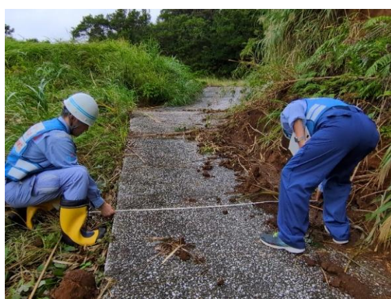
被災状況調査
