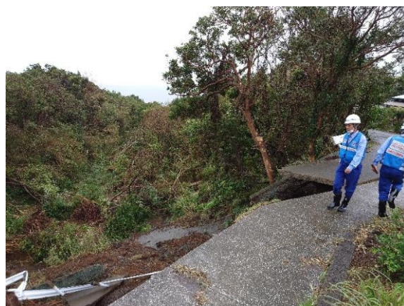
被災状況調査
