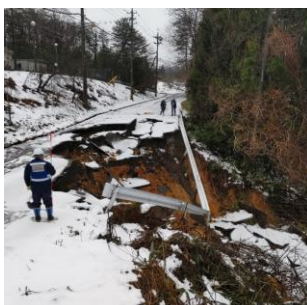
道路被害状況の調査
