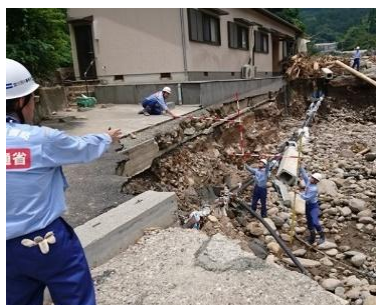
河川被害状況の調査
