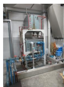
図 3 燃料小出槽（既存）
