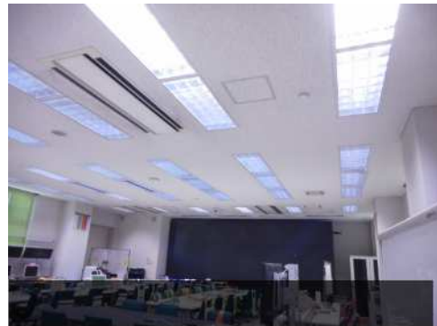
流水管理棟 照明
