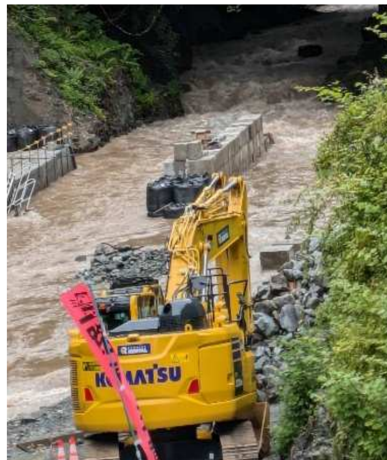
出水時重機が被害を免れた様子
