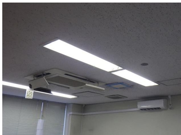
事務室室内機状況
