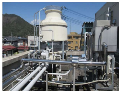
④冷却塔及び膨張タンク
