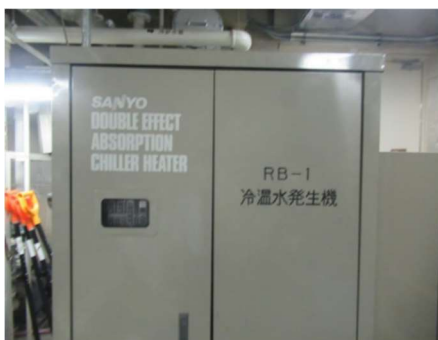
①吸収冷温水機
