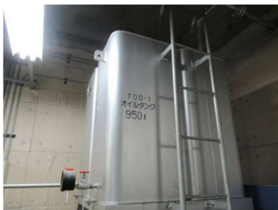
③オイルタンク
