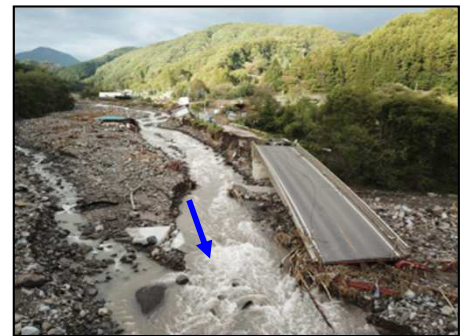
令和元年台風19号における国道144号被災状況
