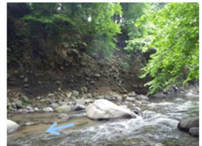
溪岸浸食状況
