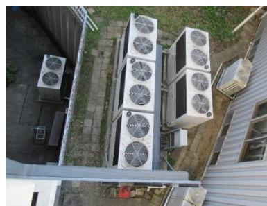
② GHP屋外機
