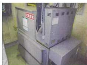
①既存油圧エレベーター機械室
