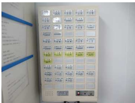
図2 事務庁舎棟（副受信機）
