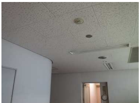
図3 事務庁舎棟（感知器）
