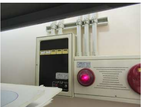
図4 第1試験研究棟（副受信機）
