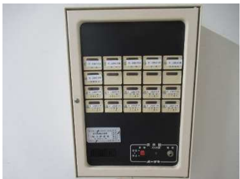
図5 第2試験研究棟（副受信機）
