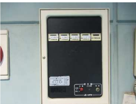
図6 第3試験研究棟（副受信機）
