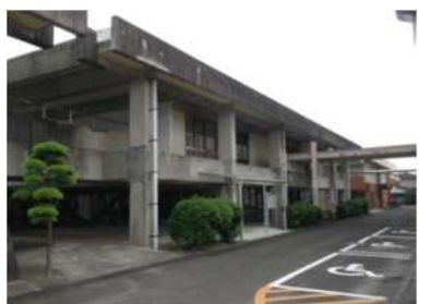
既存施設の老朽化の状況
