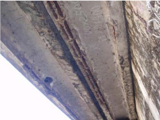
・主桁の剥離・鉄筋露出 <主桁補修>
