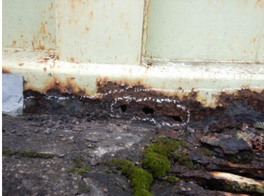
＜上部構造(地覆):腐食＞
