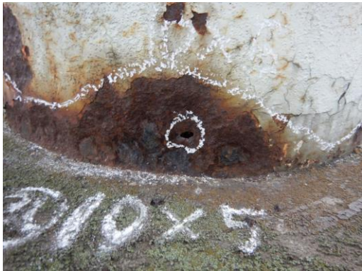
＜下部構造(柱部・壁部):腐食＞
