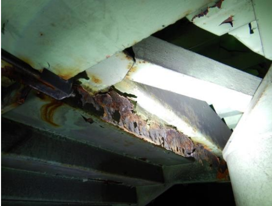
・横桁の腐食 <横桁補修>
