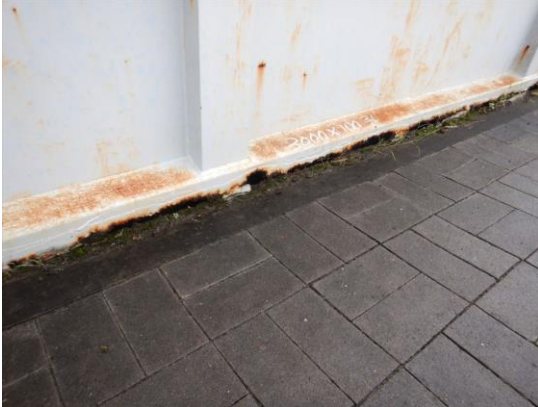
・地覆の腐食 <地覆補修>
