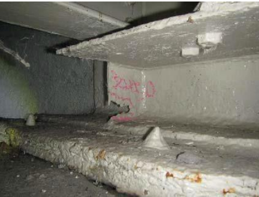
・主桁の腐食 <縦桁補修>
