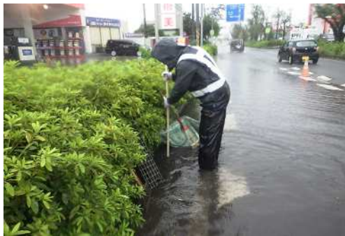
冠水処理 (国道1号)
