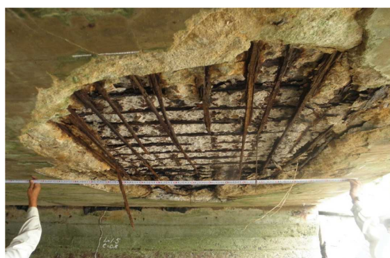
橋梁の老朽化事例 （床版鉄筋露出）
