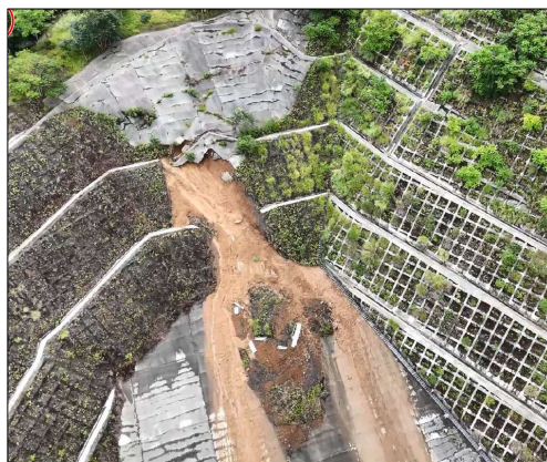
令和6年台風10号による被災状況
