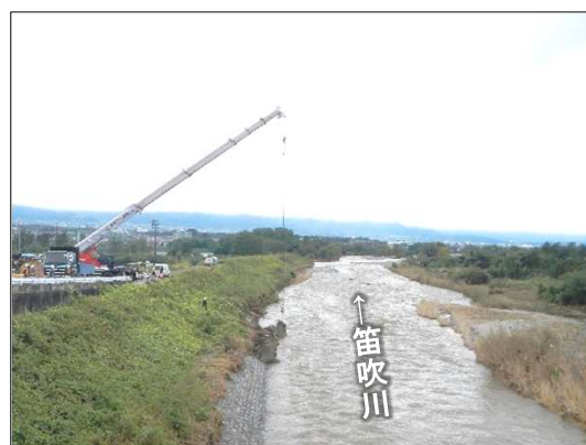
応急復旧状況(R1年洪水)
