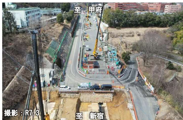
写真① 館第二トンネル 状況
