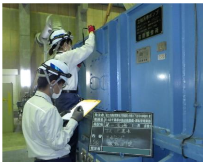
主ポンプ設備定期点検状況
