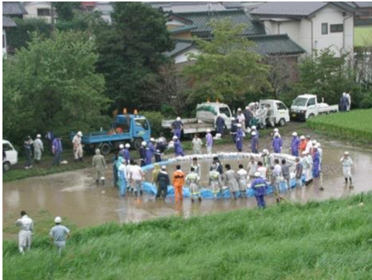
かぞし H13 利根川右岸の漏水状況 (埼玉県加須市)
