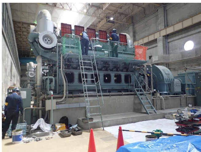
機械設備の点検・整備
