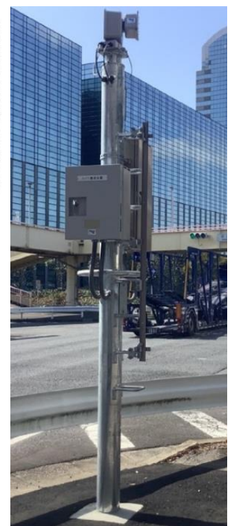
CCTV 装置(参考)
