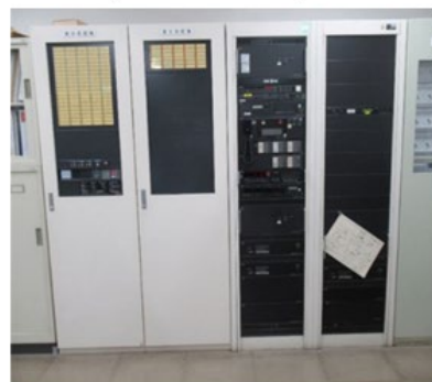
火報受信機（左側）、 拡声設備（右側）
