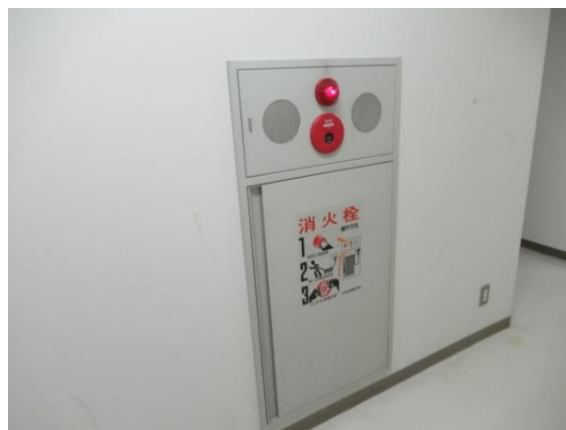
図2 消火栓ボックス
