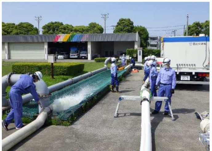
排水ポンプの排水操作（イメージ）
