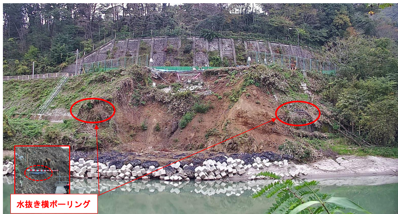
法面崩落箇所の状況：令和6年11月1日撮影
