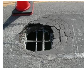
【道路が損傷した例】
