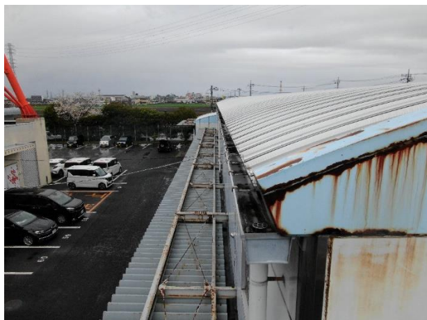
車庫 劣化状況
